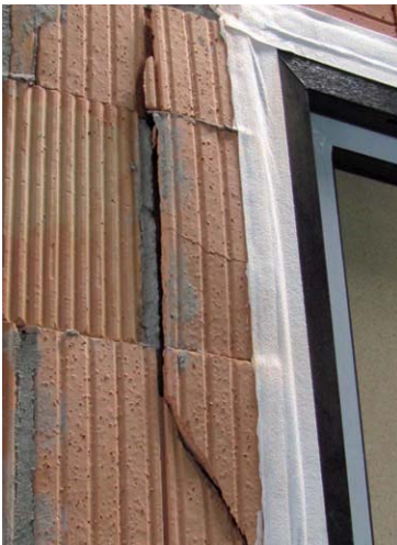
Bild 19. Steinausbruch beim Sicherheitsversuch mit 2800 Pa und einem Randabstand von nur 5 cm [16]
